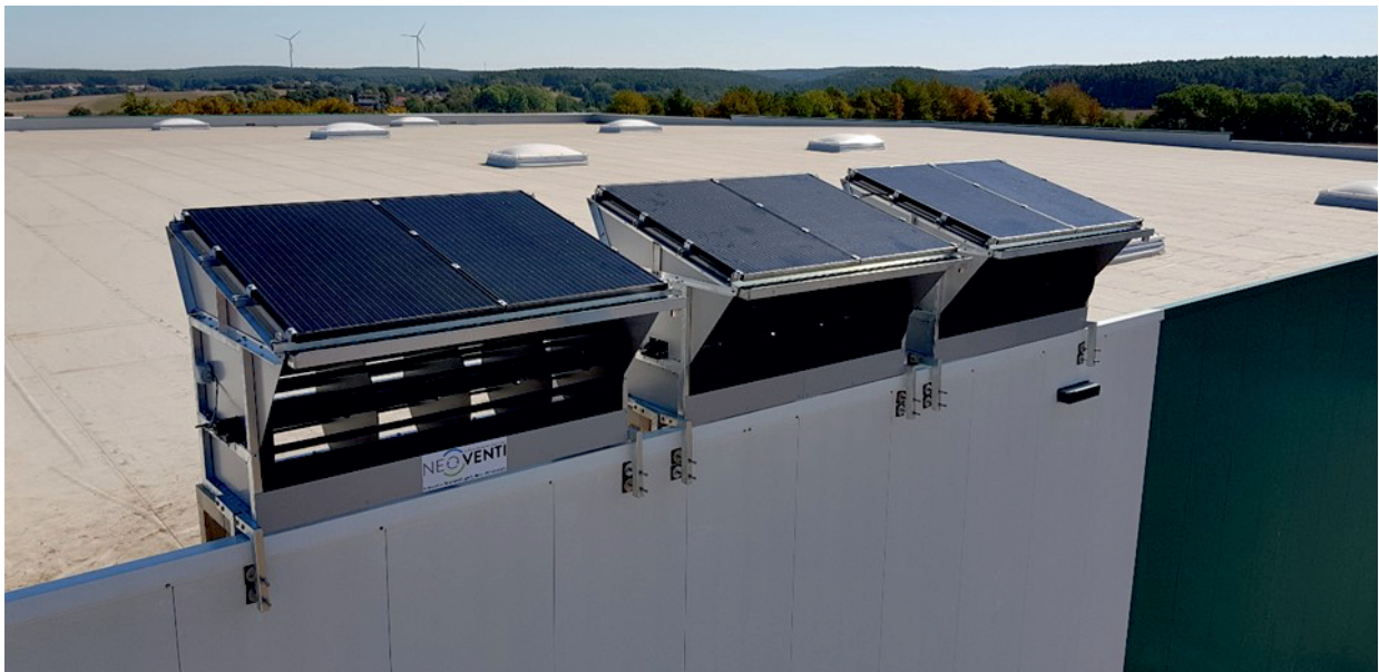
Fa. NEOVENTI Pilotanlage
